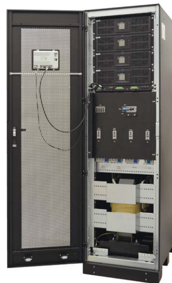
АБП с изолирующим трансформатором
